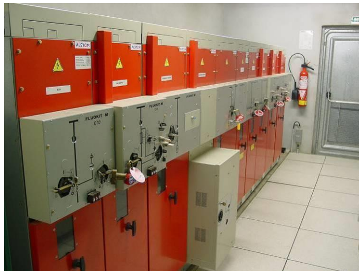
Intérieur d'un poste de livraison
